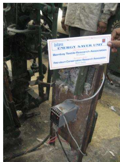
Figure 5 - Un interrupteur automatique pour économiser l'énergie - il suffisait d'y penser !
