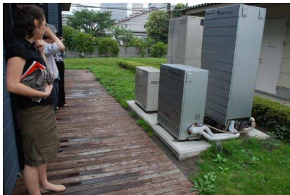
Figure 7 - Unité domestique de reformage et de cogénération de chaleur et d'électricité à Tokyo
