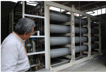
Figure 9 - Stockage d'hydrogène dans la station de recharge gérée par Tokyo Gas
